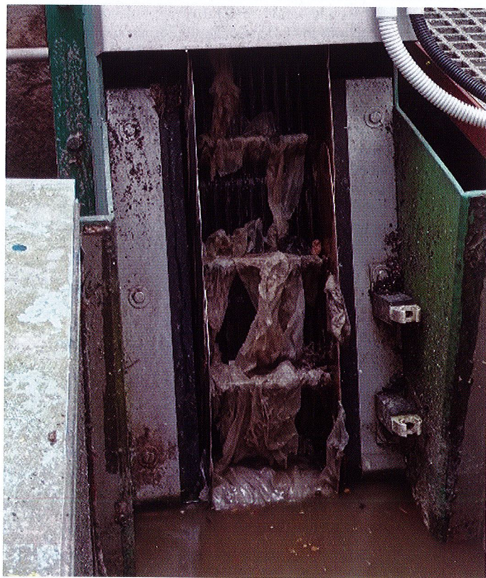
Obr. 1. Prítok nemocničních OV na ČOV FTN
